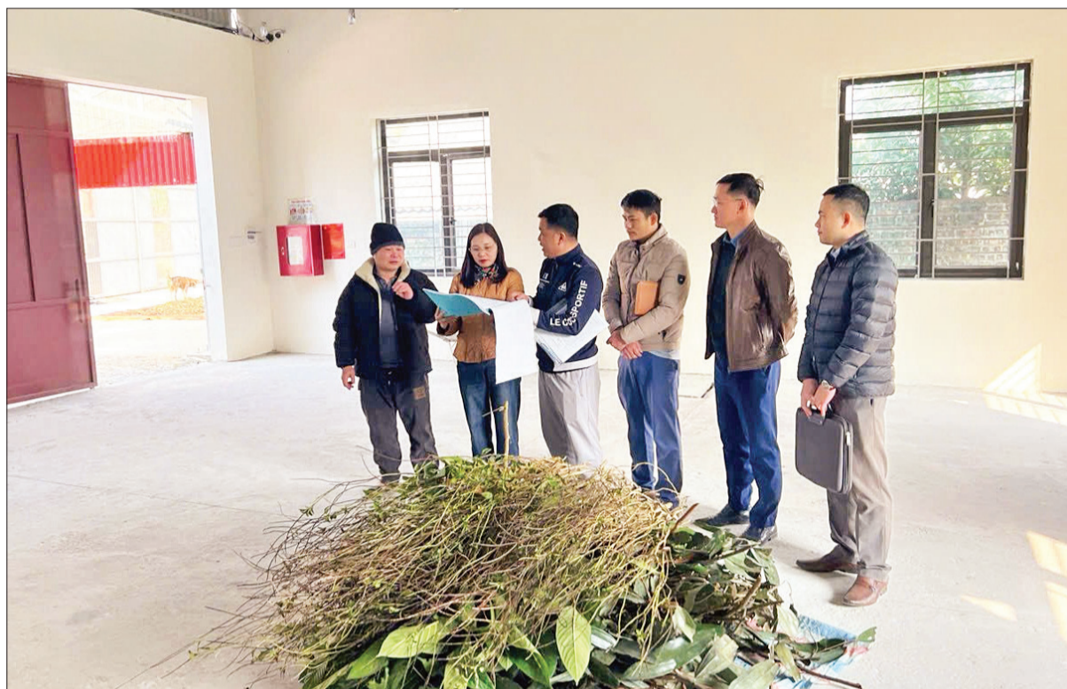
Lãnh đạo Sở Nông nghiệp và Phát triển nông thôn Bắc Kạn kiểm tra, nghiệm thu, bàn giao nhà xưởng mới xây dựng cho Hợp tác xã được liệu Bảo Châu, huyện Na Rì. (Ảnh THU TRANG)
