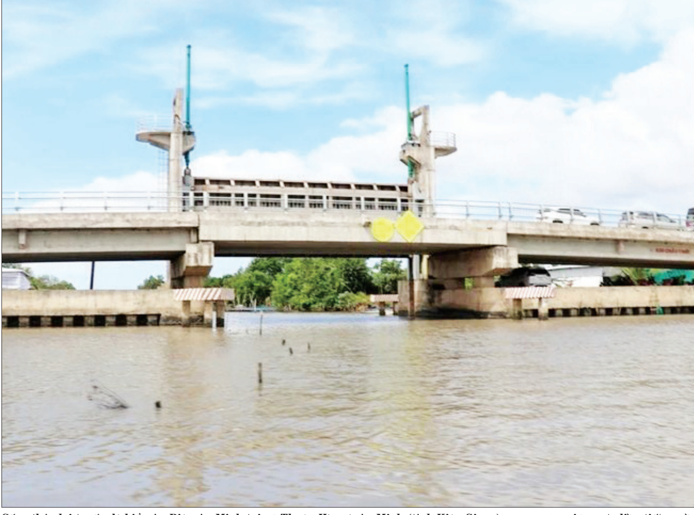
Công thủy lợi tuyến đê biển An Biên-An Minh tại xã Thuận Hòa và An Minh (tỉnh Kiên Giang), ngân mặn, giữ ngọt, điều tiết nguồn nước phục vụ sản xuất. (Ảnh HUY HẢI)
